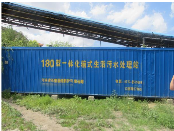
矿井工业场地生活污水处理站
